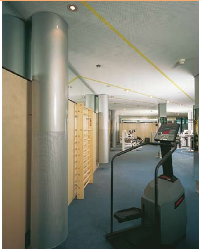
■ Quellluftdurchlässe ermöglichen durch ihre großen Eintrittsquerschnitte langsame Strömungsgeschwindigkeiten und damit eine kaum fühlbare Klimatisierung des Raumes.
